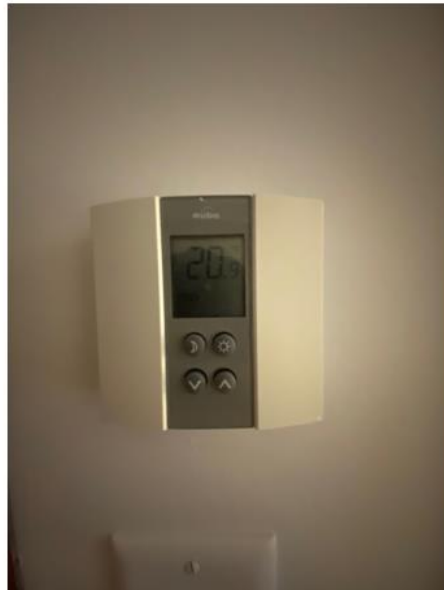
Thermostat/AC chambre bedroom
